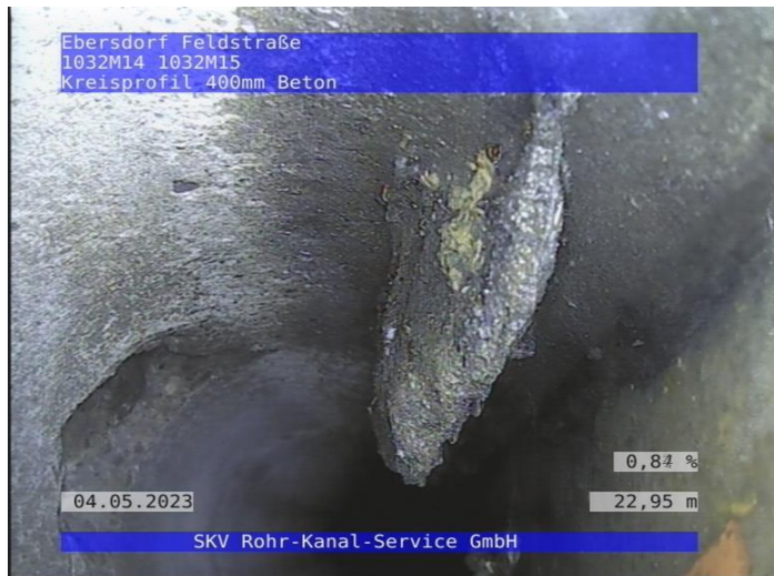
Hindernis im Kanal
